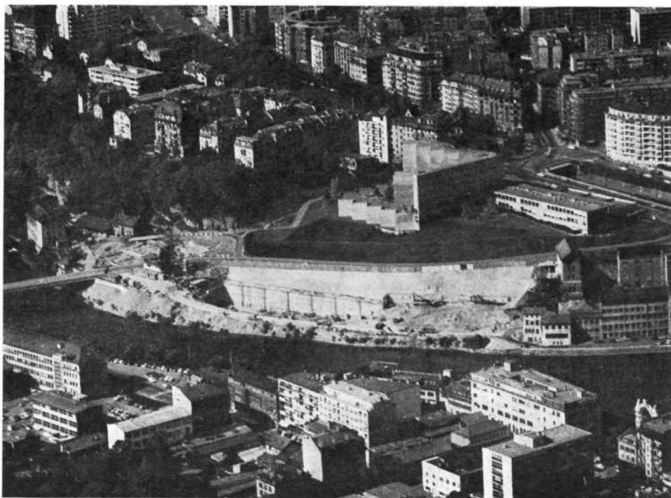
Recomposition du quartier de Sous-Terre - quai du Seujet. Vue générale du chantier de construction des bâtiments locatifs de la Ville de Genève.
